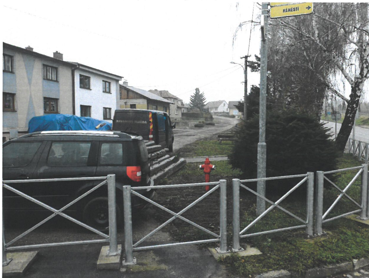
Obrázek 1: Umístění požárního hydrantu
