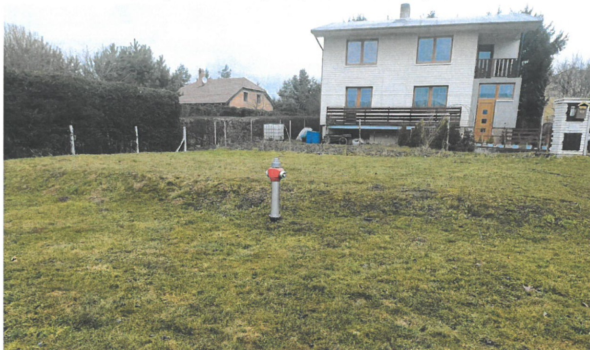
Obrázek 5: Umístění požárního hydrantu
